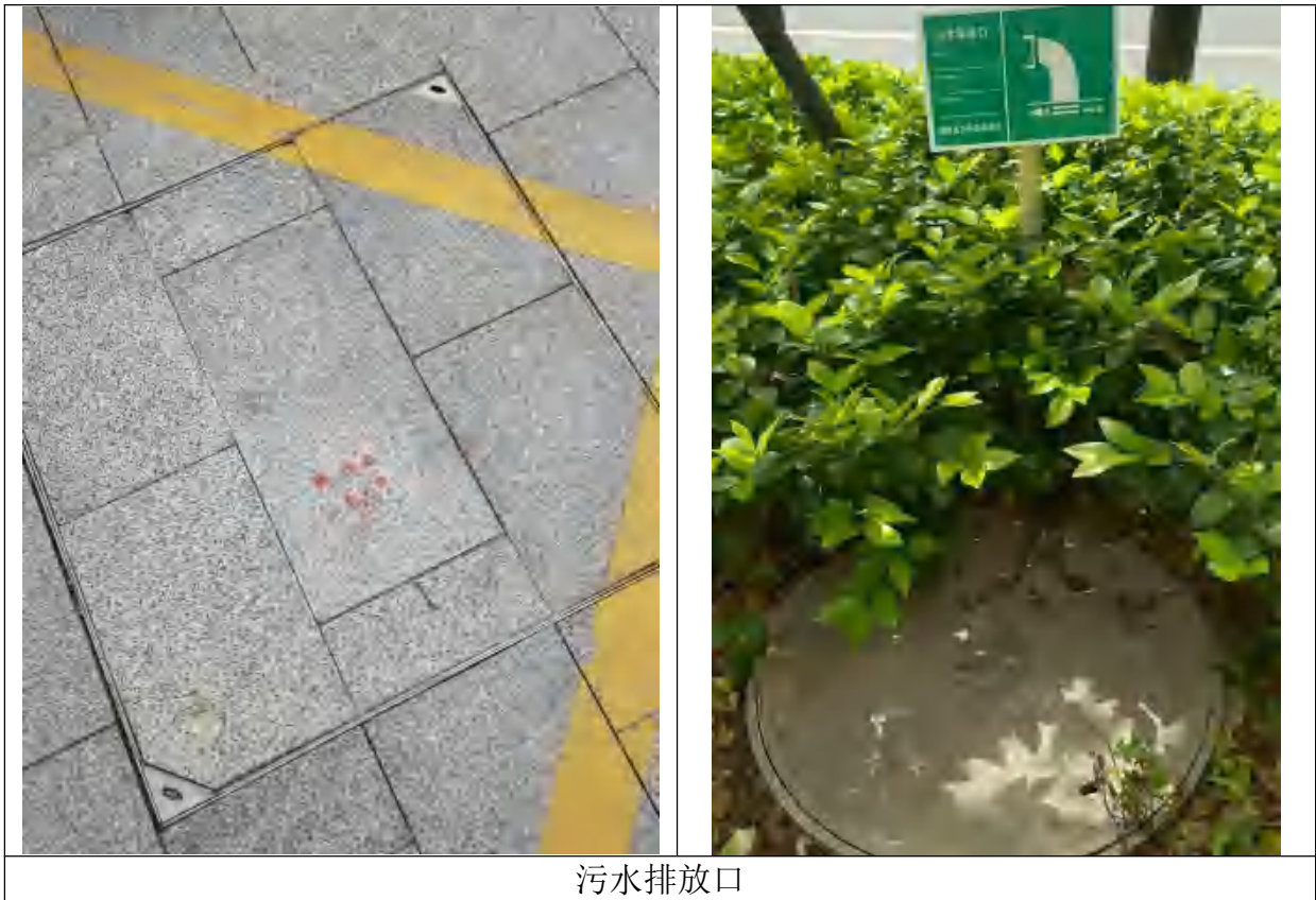
图 4-3 项目污水处理设施
