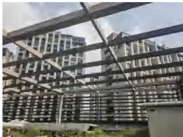
冷却塔隔声措施
