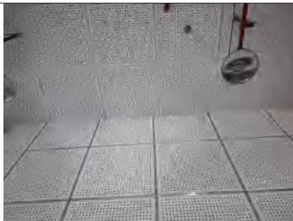
锅炉房隔声措施
