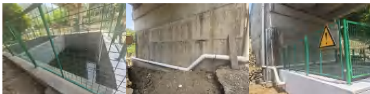
图 15 运营期桥面径流收集系统（应急池）
