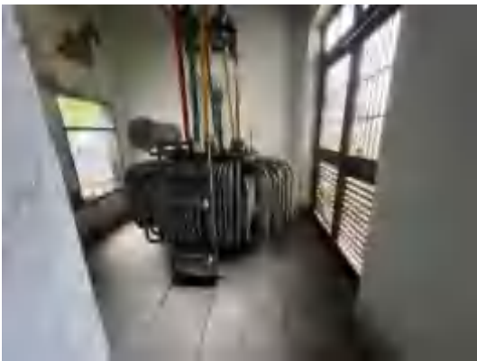
变压器改造前
