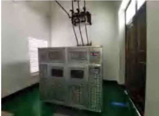
变压器改造后
