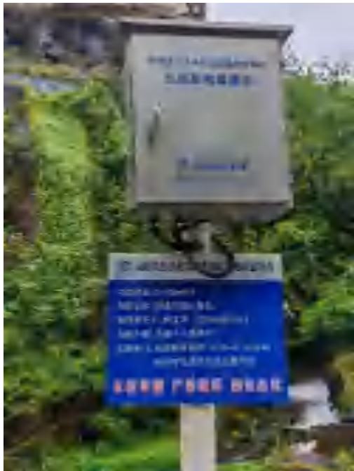
双溪坝后水电站生态流量监测
