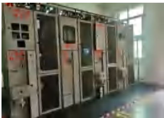
高压开关设备改造前
