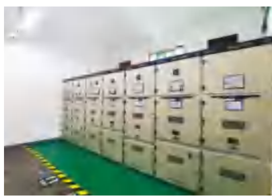
高压开关设备改造后
