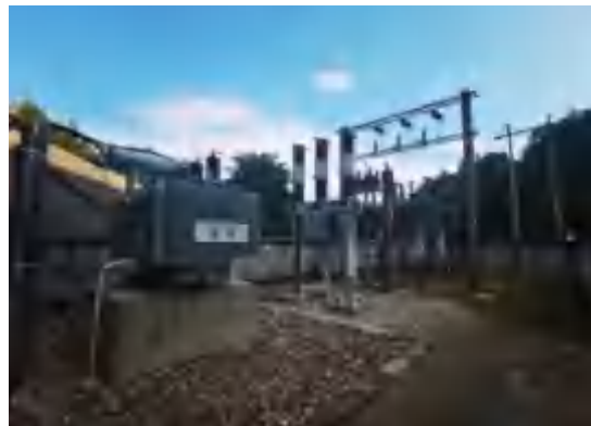
升压站改造后
