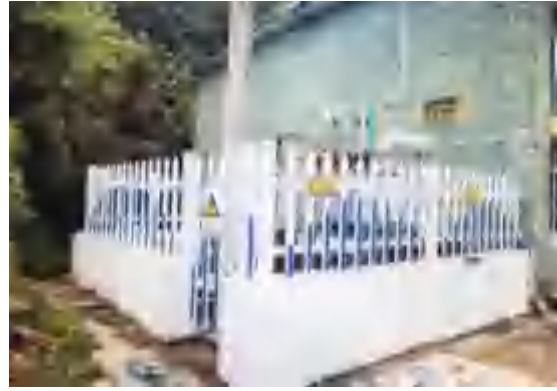
升压站改造后
