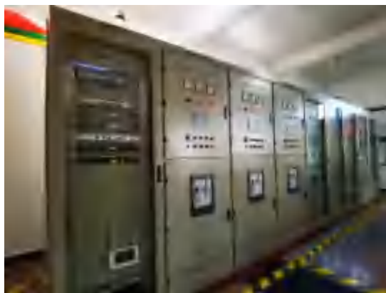
自动化控制设备改造后
