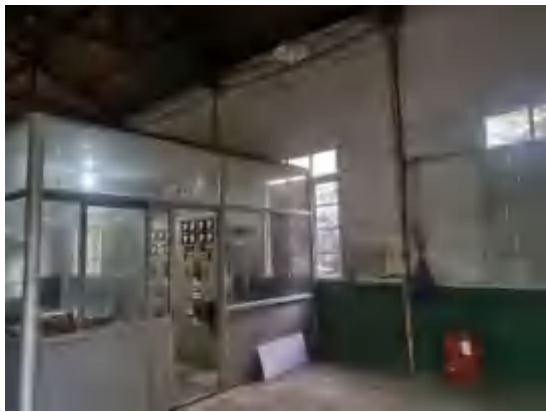
自动化屏柜改造前
