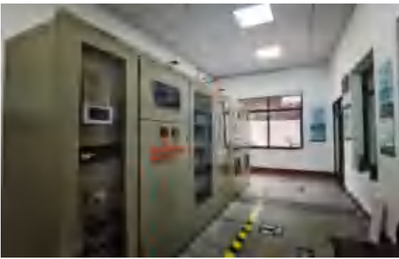
自动化屏柜改造后
