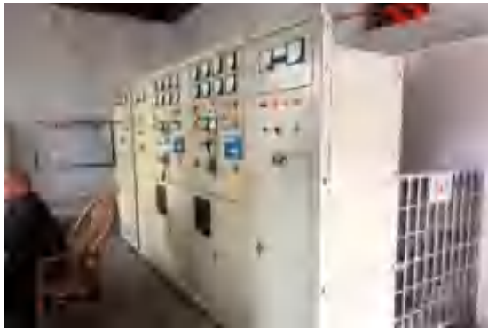
自动化屏柜改造前
