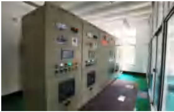
自动化屏柜改造后
