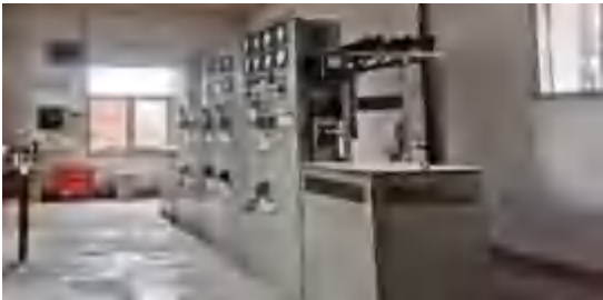
自动化屏柜改造前
